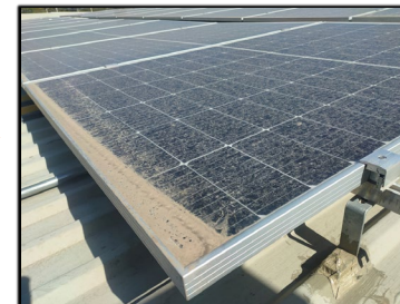
Prog. Mant. y Limpieza
