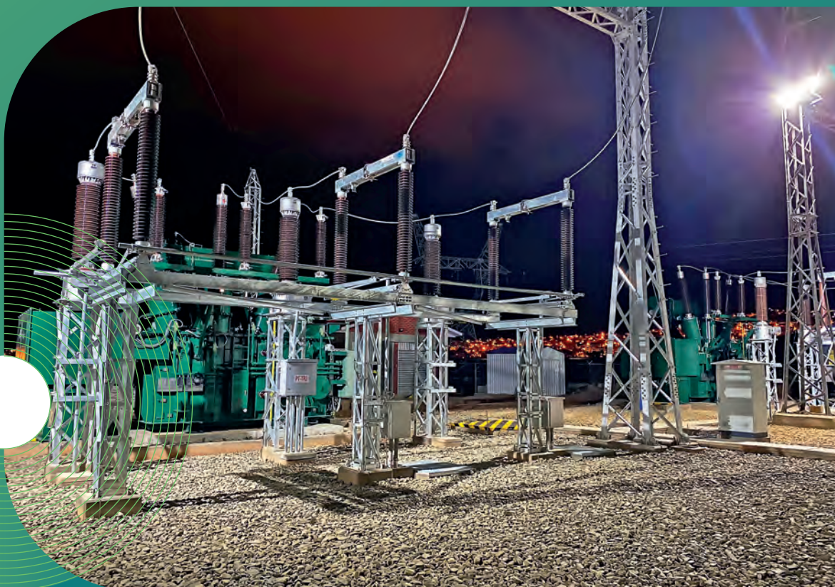
Subestación Brechas - ENDE TRANSMISIÓN
