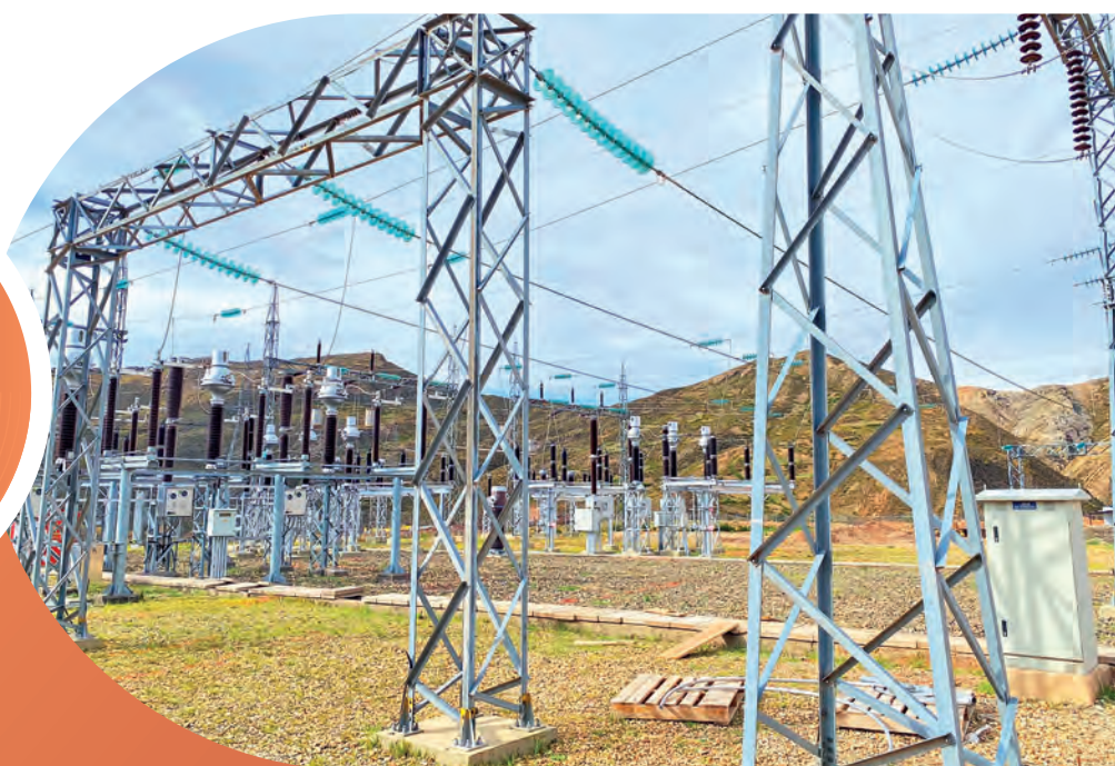
Subestación Catavi - ENDE DEORURO
