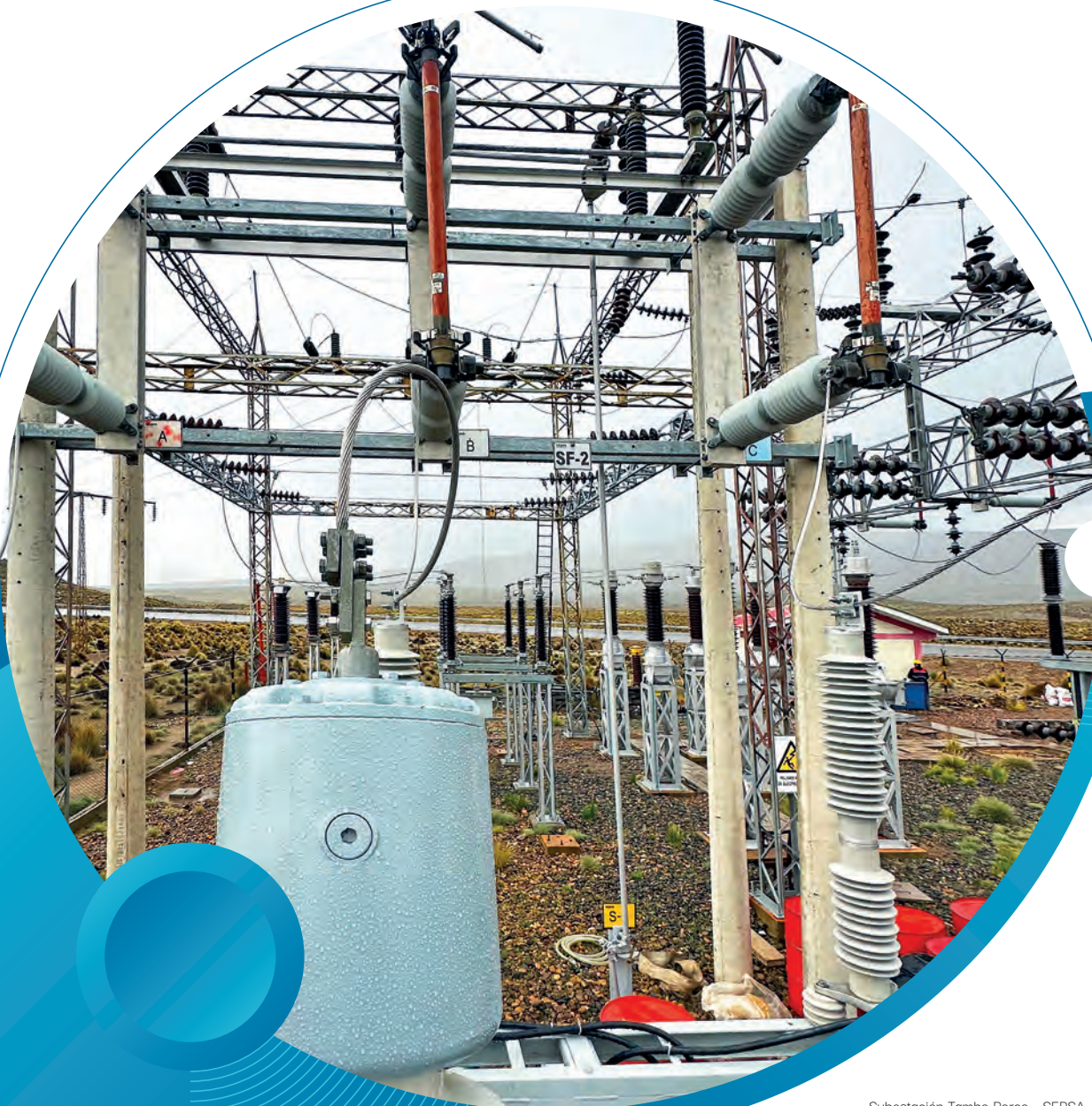
Subestación Tambo Porco - SEPSA
