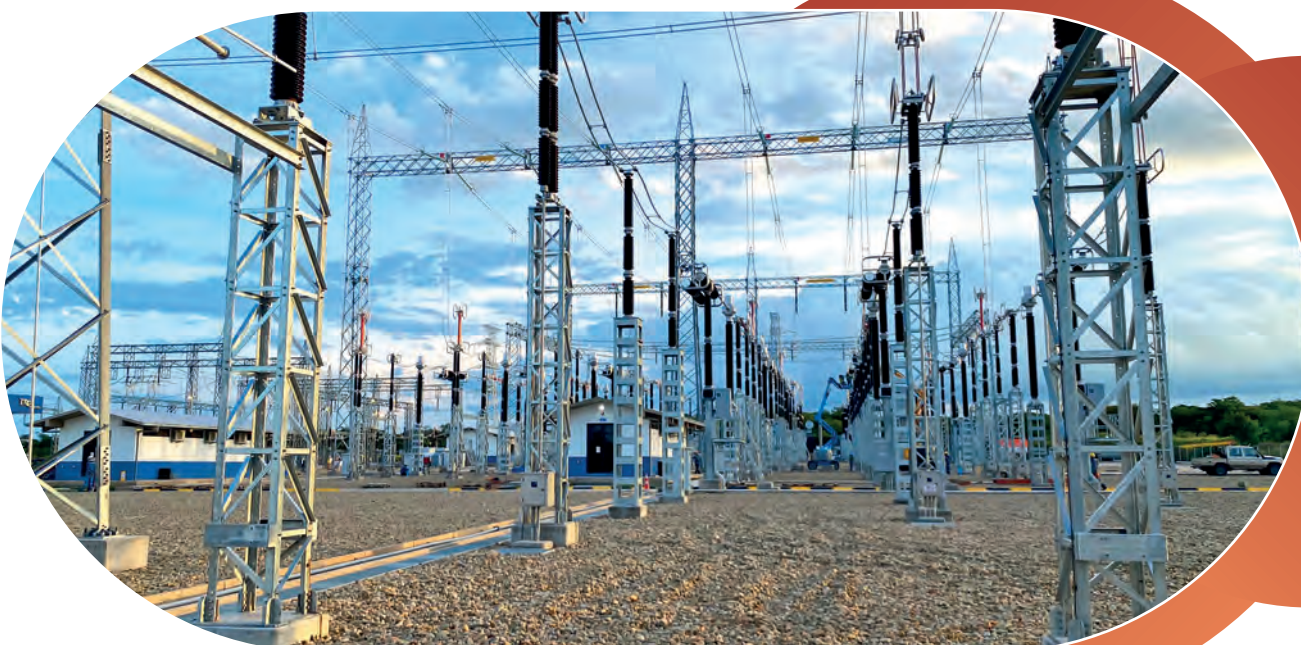
Subestación Brechas - ENDE TRANSMISIÓN
