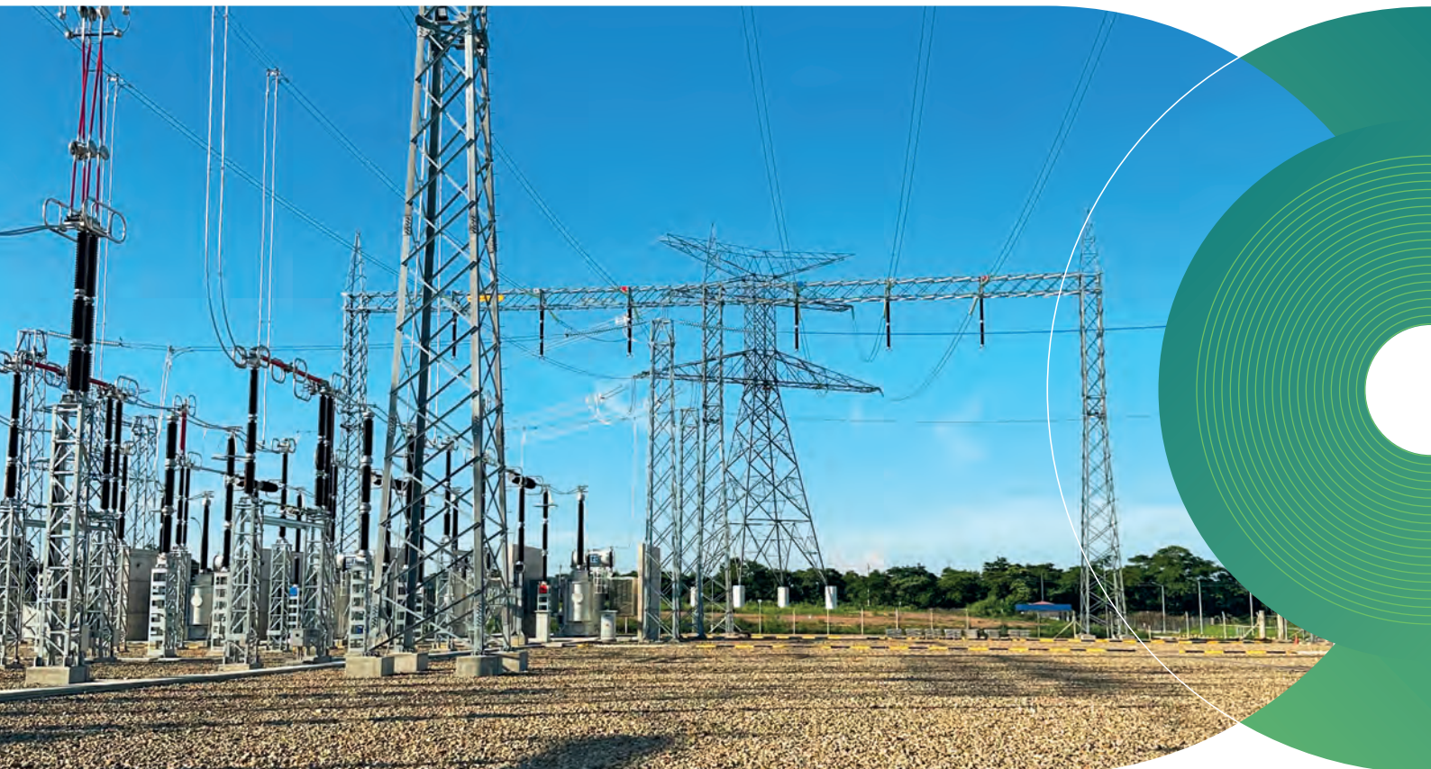
Subestación Brechas - ENDE TRANSMISIÓN
