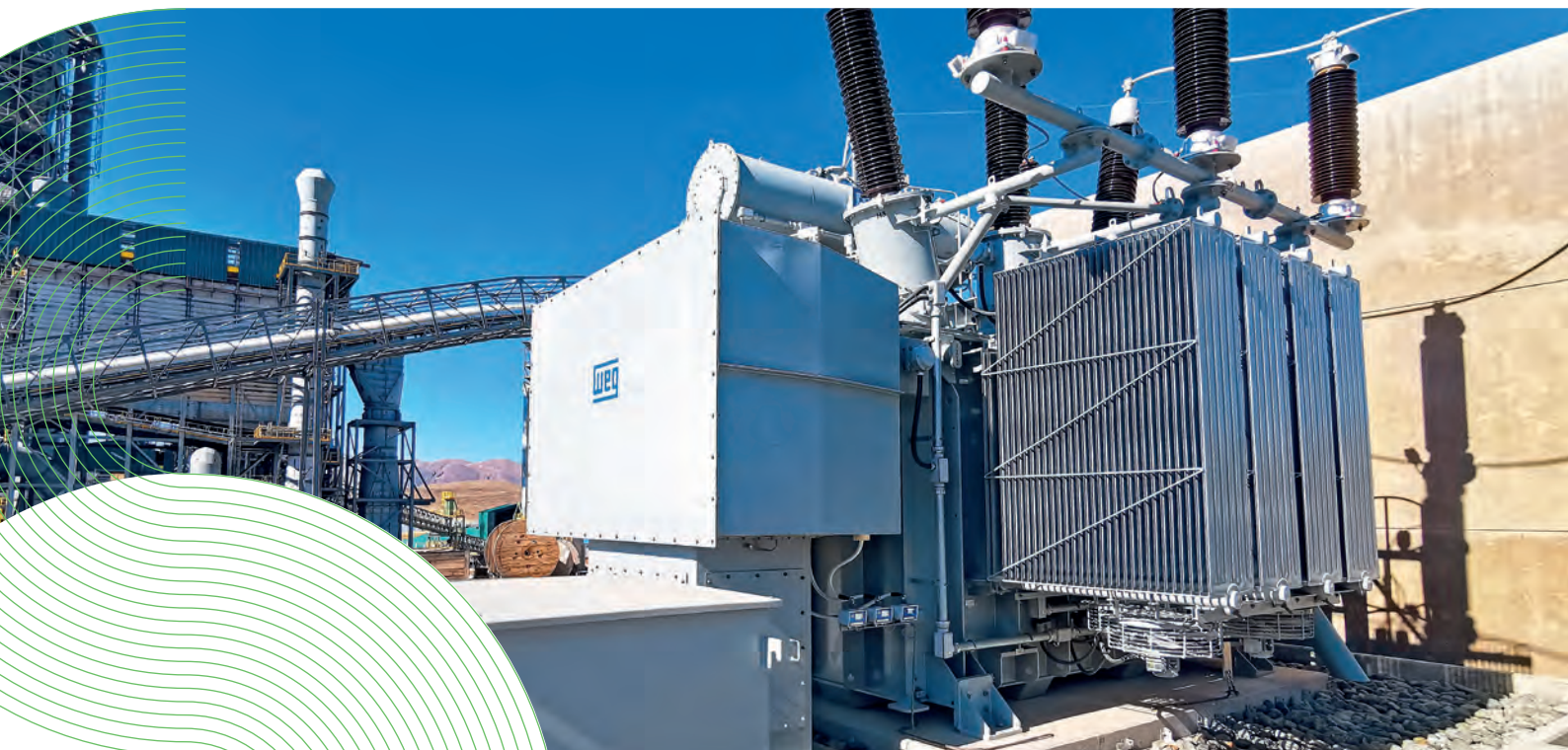
Transformador de potencia N°1 en Subestación ECEBOL Potosí - SEPSA
