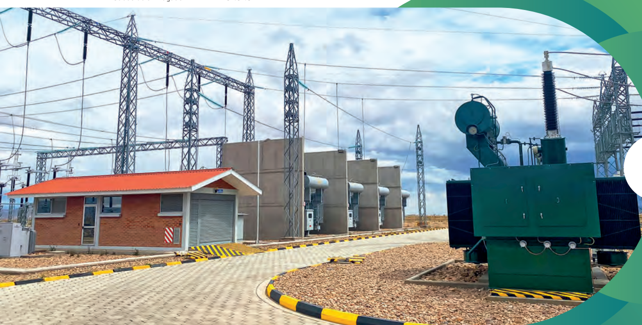
Subestación Pagador - ENDE DEORURO
