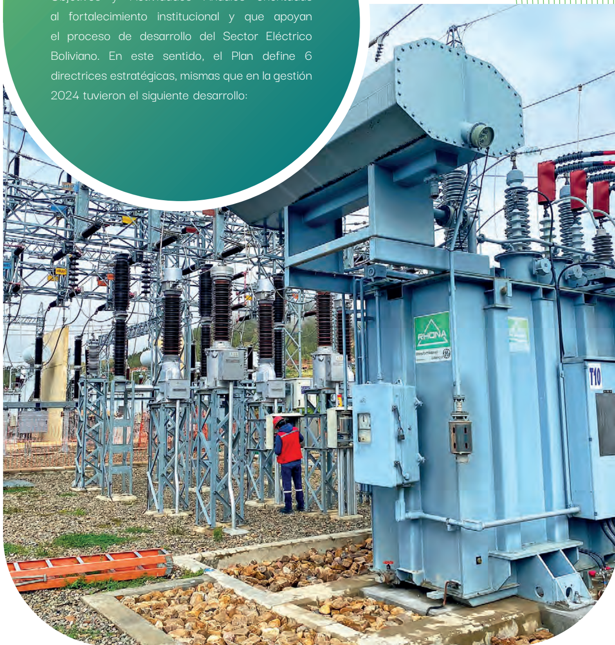
Subestación Sucre - CESSA
