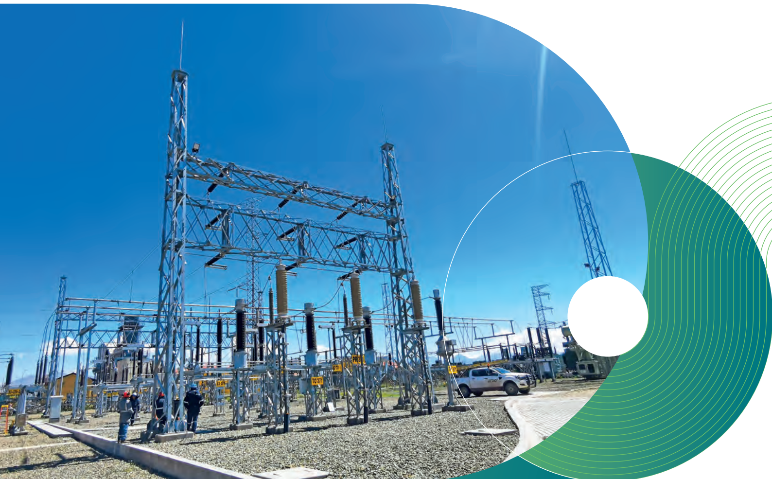
Subestación Kenko - DELAPAZ
