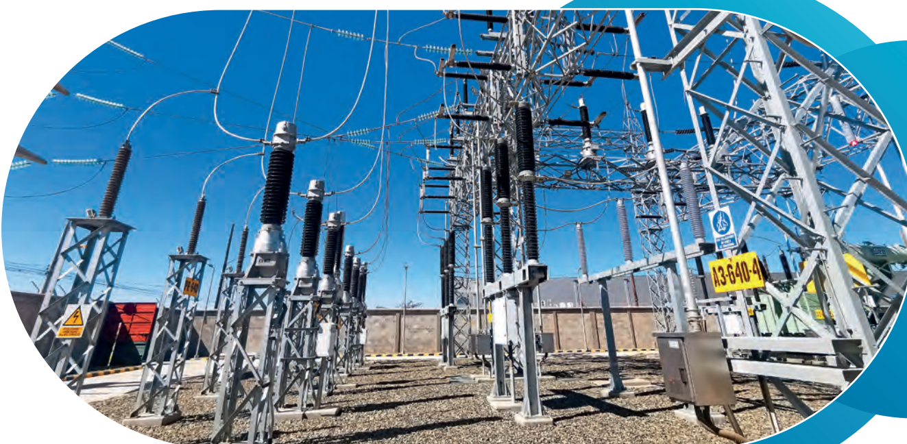
Subestación Villiroco - DELAPAZ
