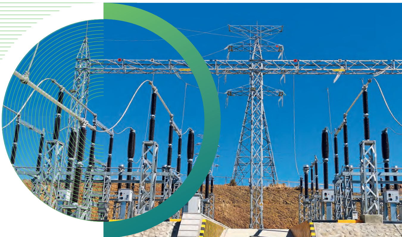
Subestación ECEBOL Potosí - SEPSA
