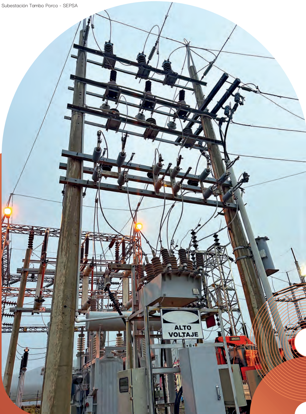
Subestación Tambo Parco - SEPSA
