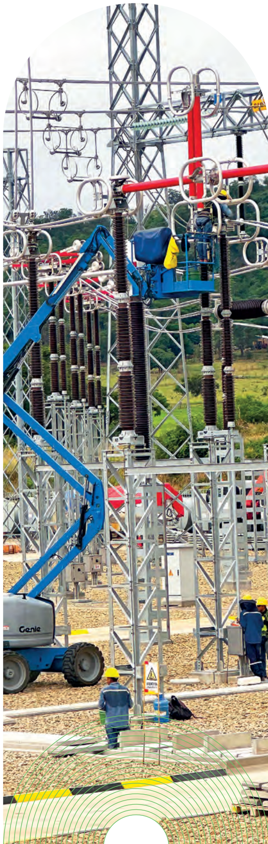
Subestación Brechas ENDE TRANSMISIÓN
