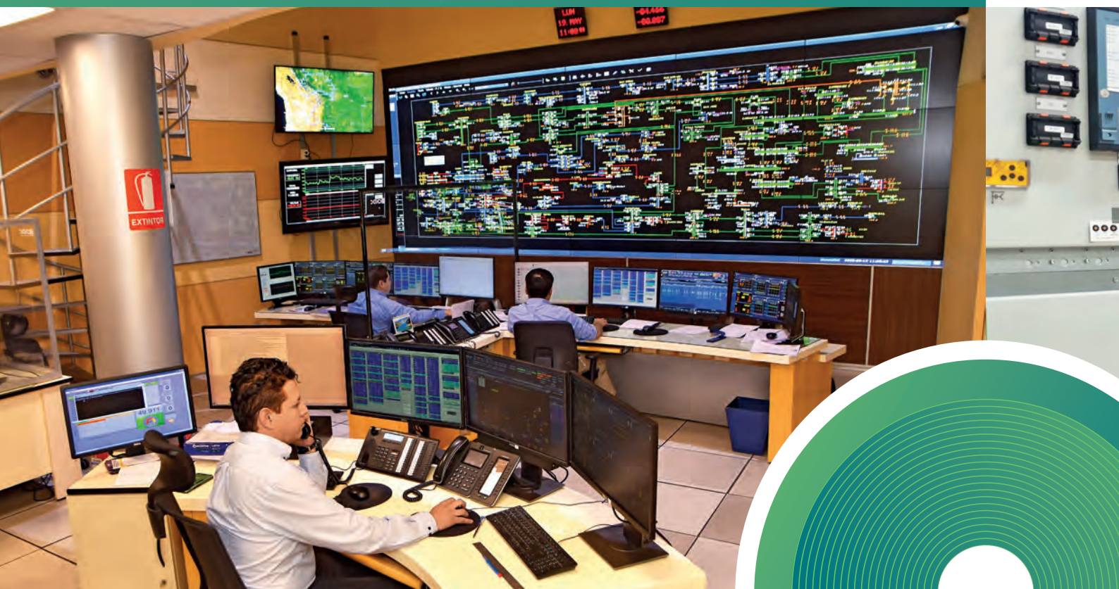
Sala de control CNDC
